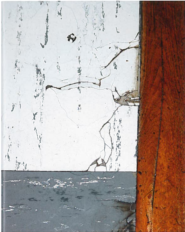
Gefahr droht, wenn Heimwerker asbesthaltige Floorflex-Platten entfernen
