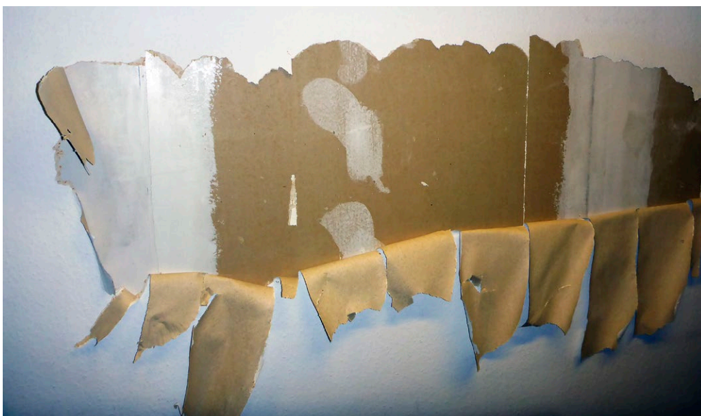
Gipskarton-Spachtelmasse hinter einer Tapete
