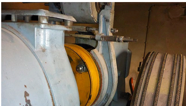
Aufzugsanlage mit asbesthaltigen Bremsbelägen
