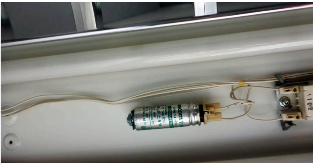
Kondensator: Über den Aufdruck kann erschlossen werden, ob er polychlorierte Biphenyle (PCB)-enthält.
