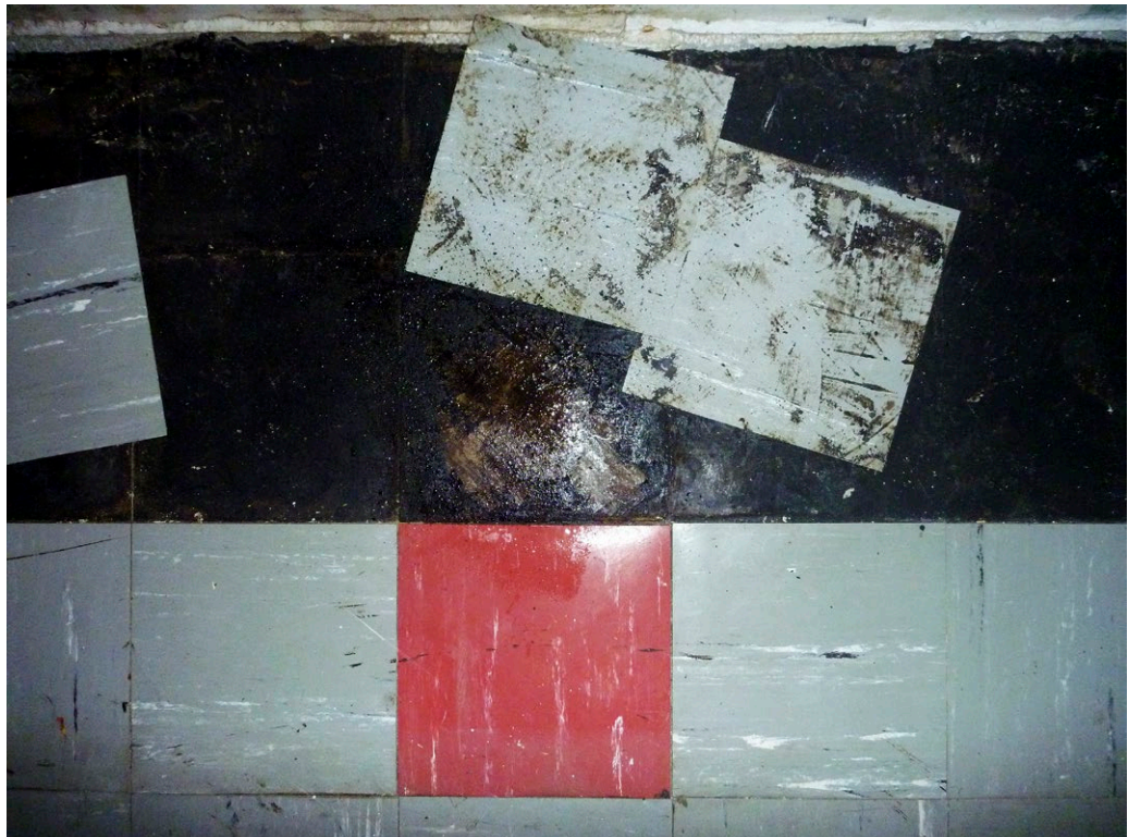
Asbesthaltige Polyvinylchlorid (PVC)-Fliesen „Floor Flex“ verarbeitet mit asbest- und polyaromatischen Kohlenwasserstoff(PAK)-haltigem Belagskleber
