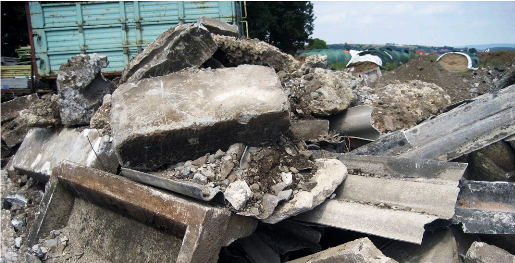
Darf nicht mehr vorkommen: Asbestzementplatten im Bau- schutthaufwerk
