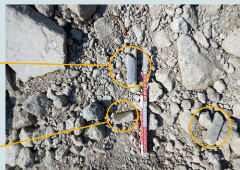
Bauschutt: Asbesthaltige Rohrhülsen und Abstandshalter
