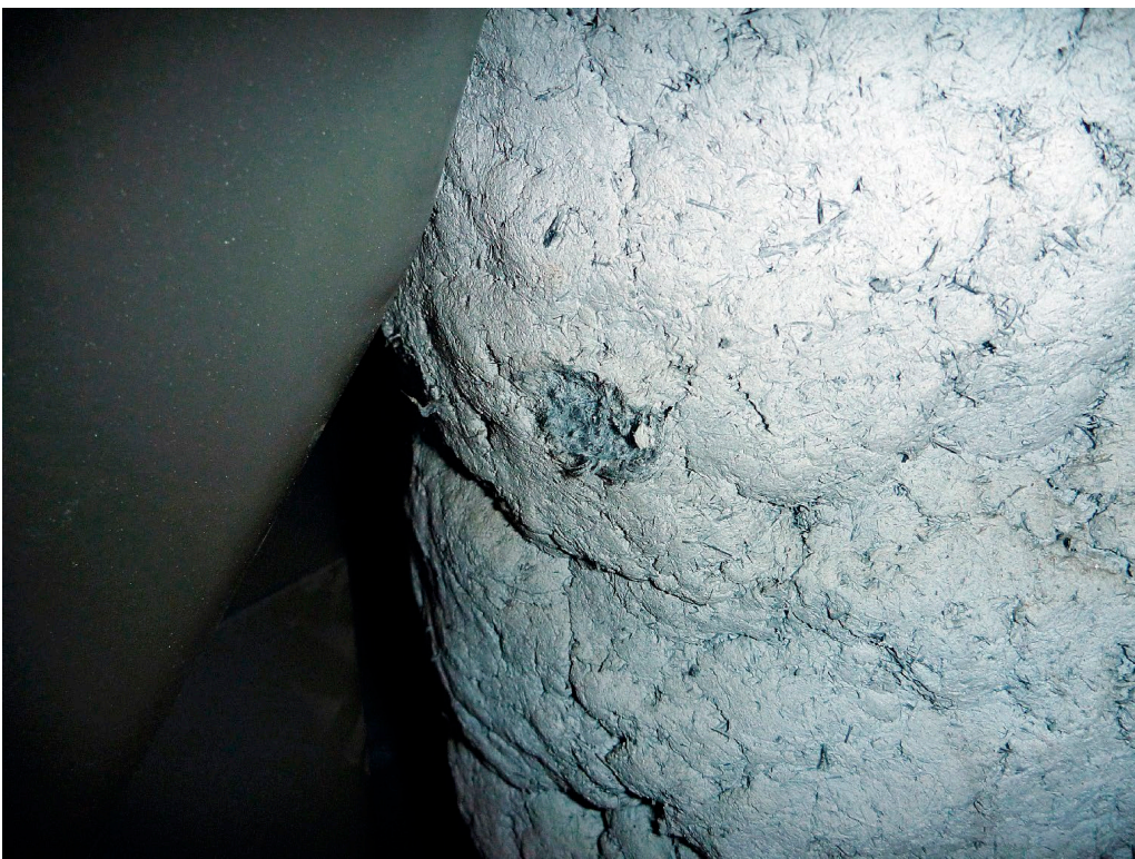
Schwach gebundener Asbest: Spritzasbest
