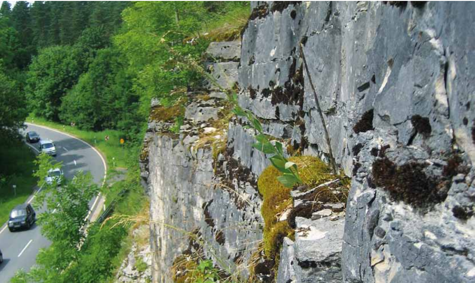
Malerische Felswände aus Kalkgestein täuschen darüber hinweg, dass sich jederzeit ein Felsbrocken lösen und Personen oder Sachwerte gefährden kann.
