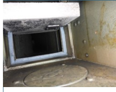
Abb. 4-5-220: Brandschutzklappe mit asbesthaltiger Dichtung
