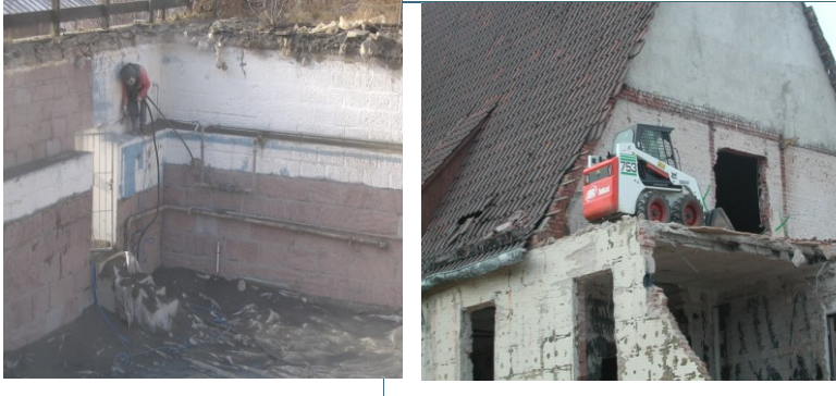
Abb. 6-110: Arbeitsschutz wird nicht immer ausreichend berücksichtigt
