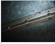
Abb. 4-5-225: Asbestschnur als Flanschdichtung an einem Lüftungskanal
